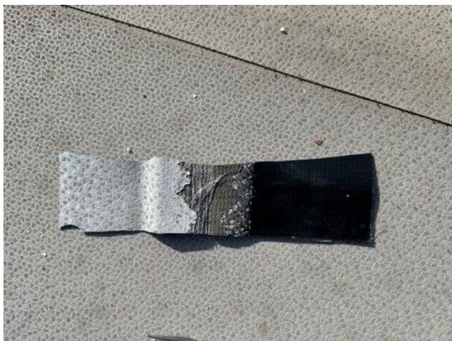
foto /11/ Orientační zkouška kvality spoje hydroizolace – delaminace fólie v místě roztržení
